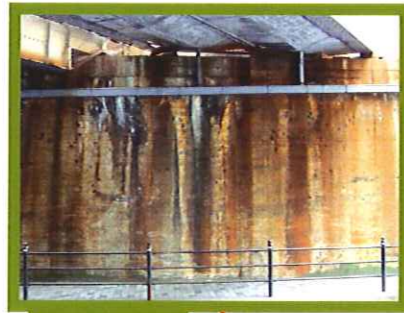
東海道線の橋脚には、昭和20(1945)年6月の空襲で米軍攻撃機による機銃掃射の弾痕が残っています。
