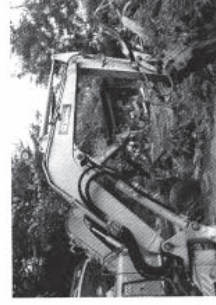
【写真20】エンボを使ってあってという間に解体していく。(8月6日)
