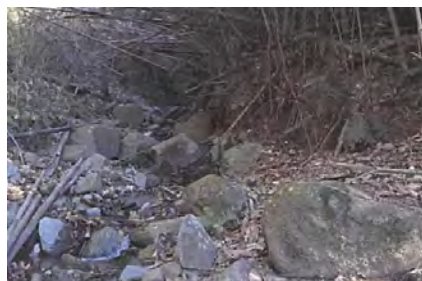
集中豪雨による開墾畑の石垣の崩壊跡
