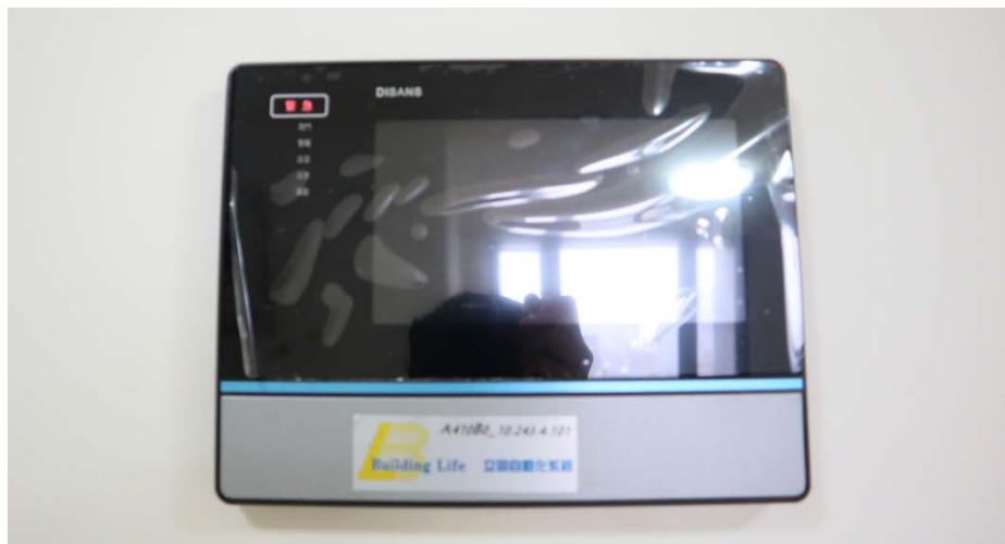
図 7-3 各住戸に設置されている通信機器
